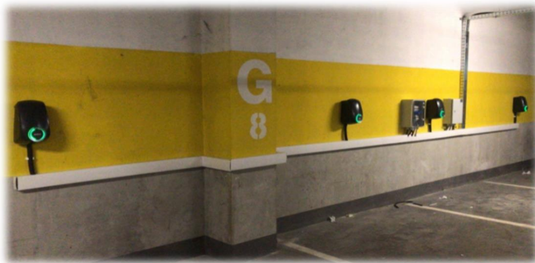
Prize de încărcare a mașinilor electrice montate la Shopping City Tg Jiu
